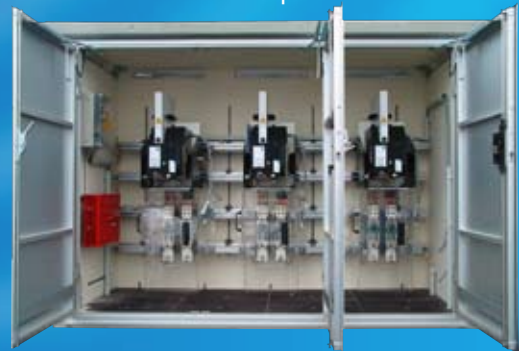
Station mit 3 Gleichstromleistungsschalter 1600A Station with 3 DC Circuit Breaker 1600 A
